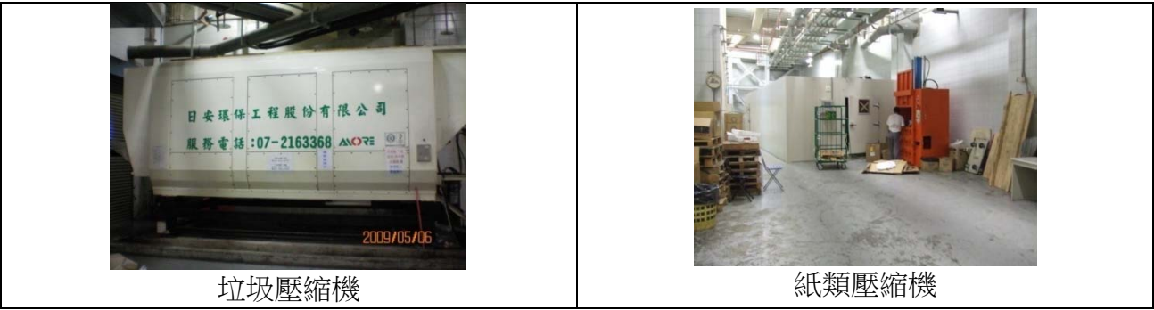
圖 12-17 垃圾壓縮設施
